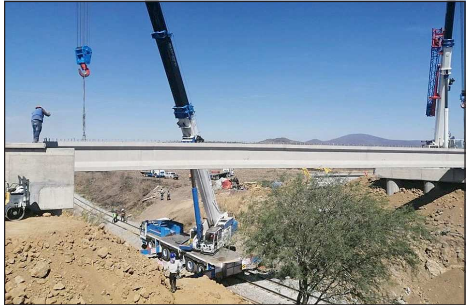
Yurécuaro, Mich.- Aún en medio de las adversidades, el municipio encabezado por el Lic. Gilberto Alvarado Méndez continúa trabajando para unir a nuestras comunidades con seguridad y eficiencia. Pronto el nuevo puente Mirandillas será una realidad.
