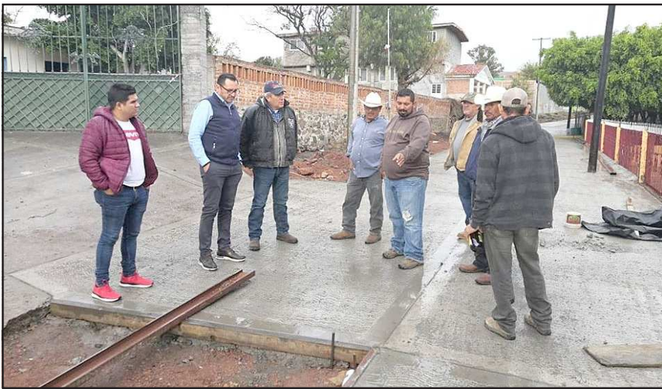
Yurécuaro, Mich.- El diputado Hugo Anaya visitó acompañado del director de Obras Públicas del municipio la comunidad de La Joya, para revisar los avances de la obra de pavimentación que se está realizando en una de las principales calles de dicha comunidad.
